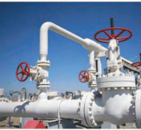
Industrial Piping Endüstriyel Boru Hatları
